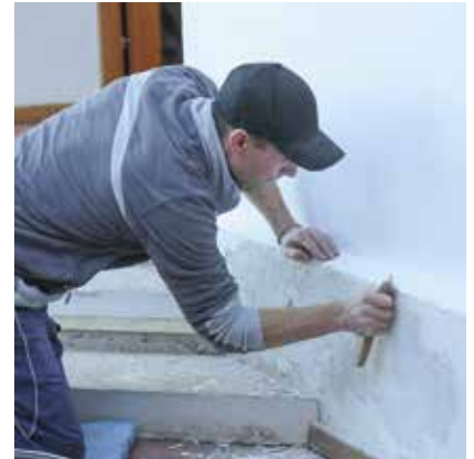
Restaurant. Neue Stufen gibts vom Restaurant in die Bauernstube, und an der Wand muss auch gearbeitet werden
