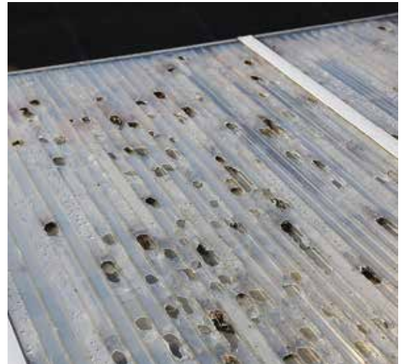
Hagelschäden 2021. Die Lichtstegplatten bei den Balkonüberdachungen der Seglerheime sollen jetzt erneuert werden
